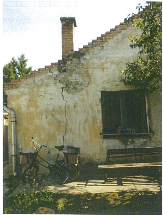
Függőleges repedés a szoba és az előtér között
