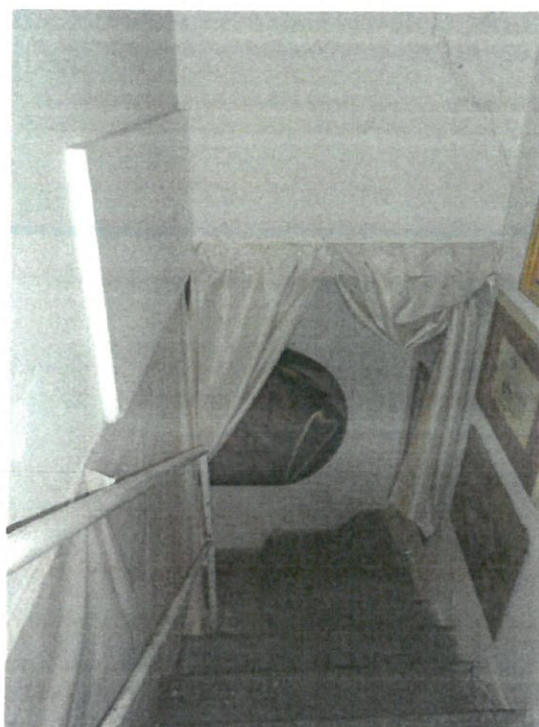
Feljárati a műterembe (balesetveszélyes)
