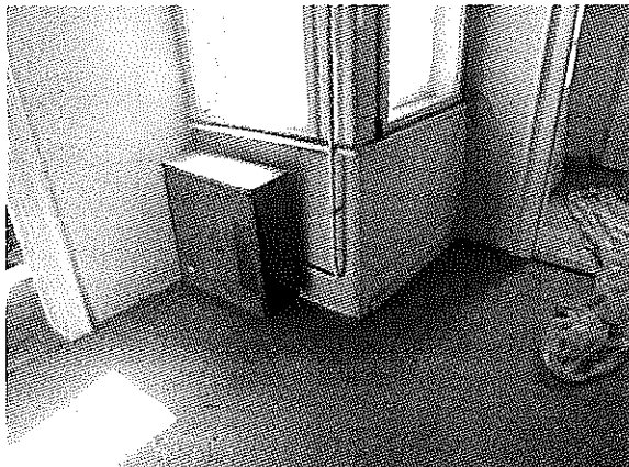
38. Konvektor az emeleti közlekedőn
