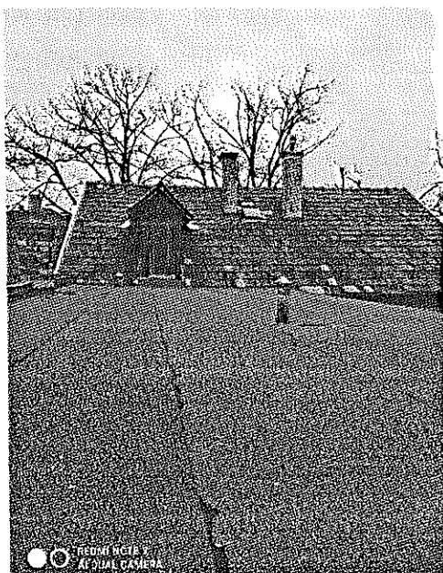
5. kép: megsüllyedt magastető - lapostető találkozás
