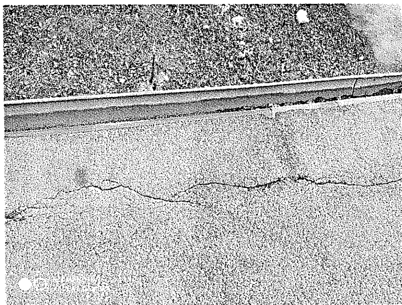
6. kép: bitumenes vízszigetelés repedése
