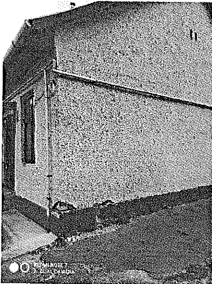
2. kép: külső oldali lábazat állapota
