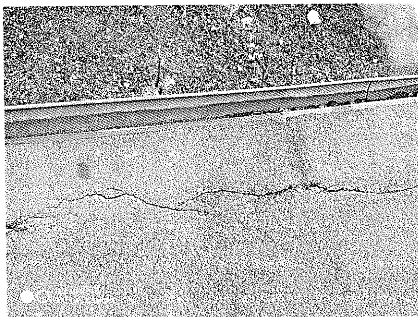
6. kép: bitumenes vízszigetelés repedése
