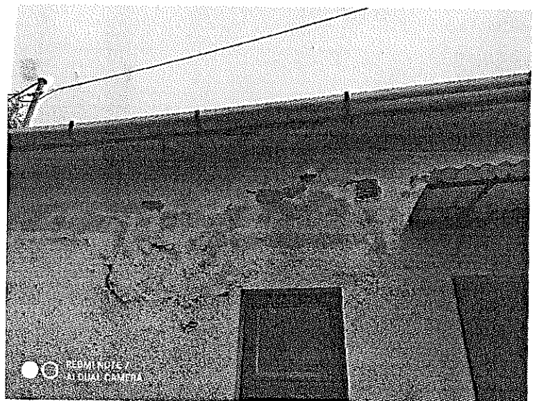
2. kép: sérült vízvezetés miatt a vakolatot hátulról bomlasztja a nedvesség
