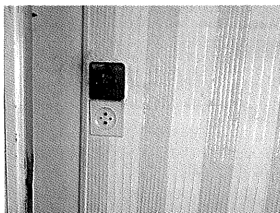
41. Főépület: PE vezető nélküli dugaszoló aljzat
