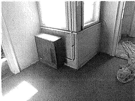
38. Konvektor az emeleti közlekedőn
