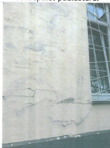
Homlokzati hibák a főépületen.
