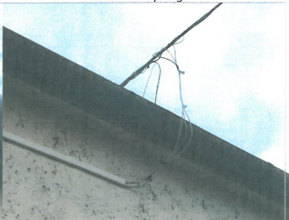
Karbantartás igénylő elektromos hálózat.
