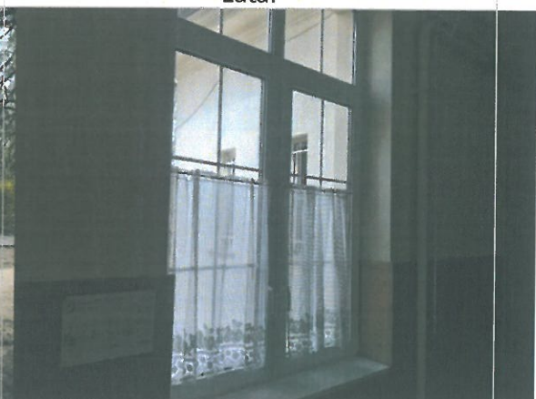
A 2000-es évek elején beszerelt műanyag nyílászáró.
