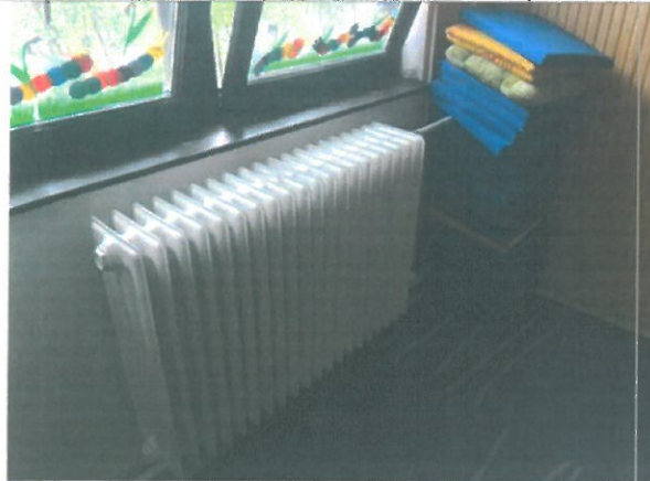
Hőleadó az épületben.
