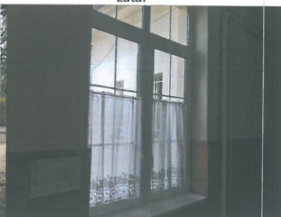
A 2000-es évek elején beszerelt műanyag nyílászáró.
