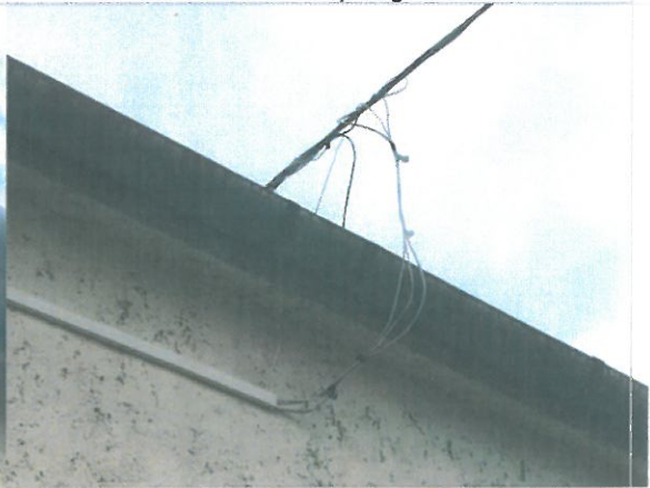
Karbantartás igénylő elektromos hálózat.
