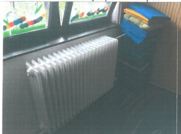
Hőleadó az épületben.
