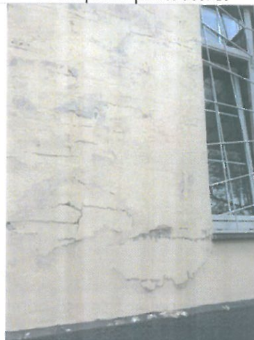
Homlokzati hibák a főépületen.
