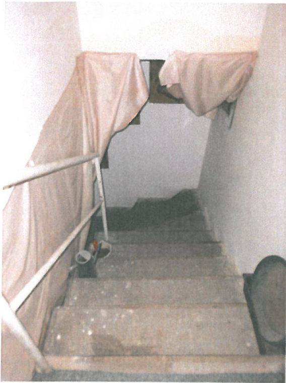
Feljárati a műterembe (balesetveszélyes)
